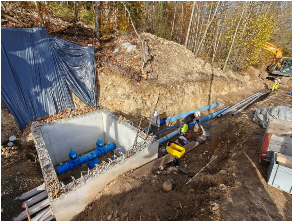
Conduites de transport (Cormoret – Saint-Imier) et chambre de vannes à proximité du Passage de la Raissette.
