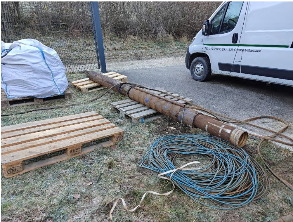
Station des Sauges : Pompe immergée du puits SON3 après son extraction suite à une panne.
