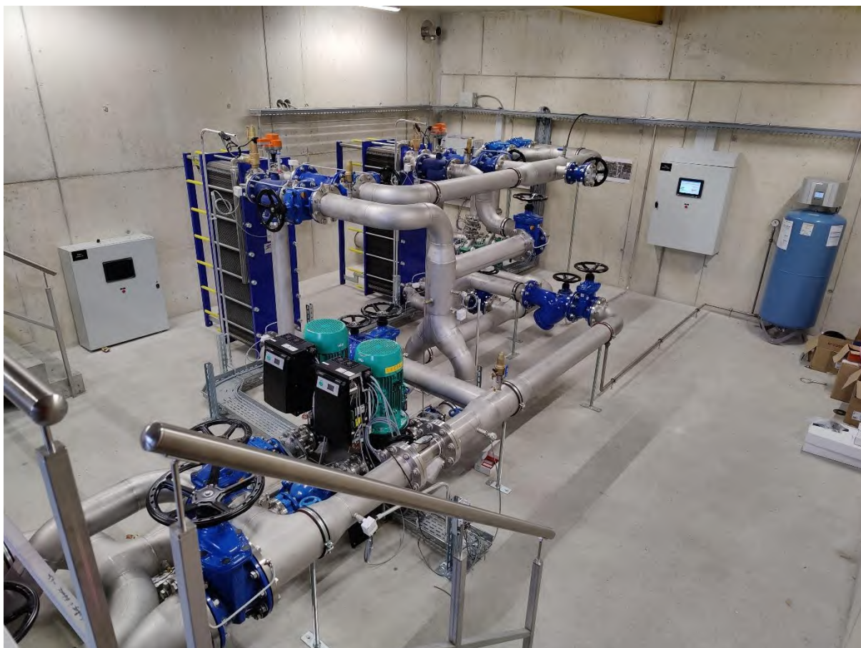
L'échangeur de chaleur du réservoir des Philosophes.
