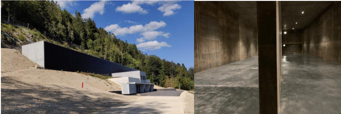
Le réservoir des Philosophes avec, à droite, un bassin de deux compartiments dans lequel on peut stocker au total 1500 m 3 d'eau potable.
