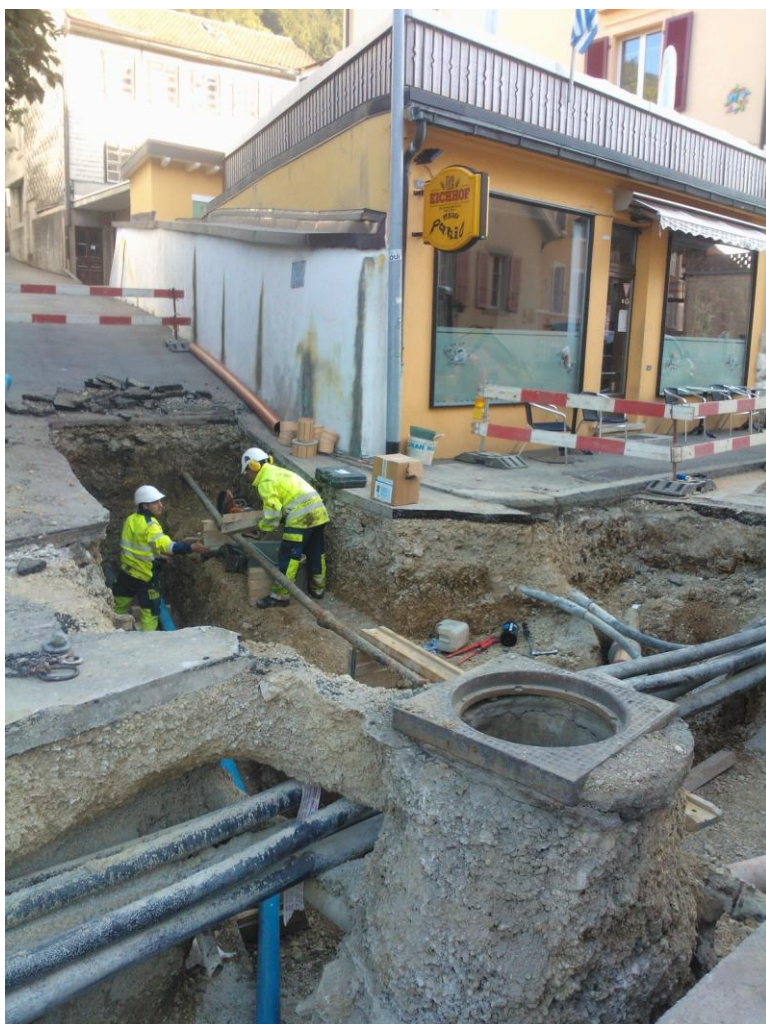
Le vieillissement de conduites séculaires impose leur remplacement à la Rue de la Cure
