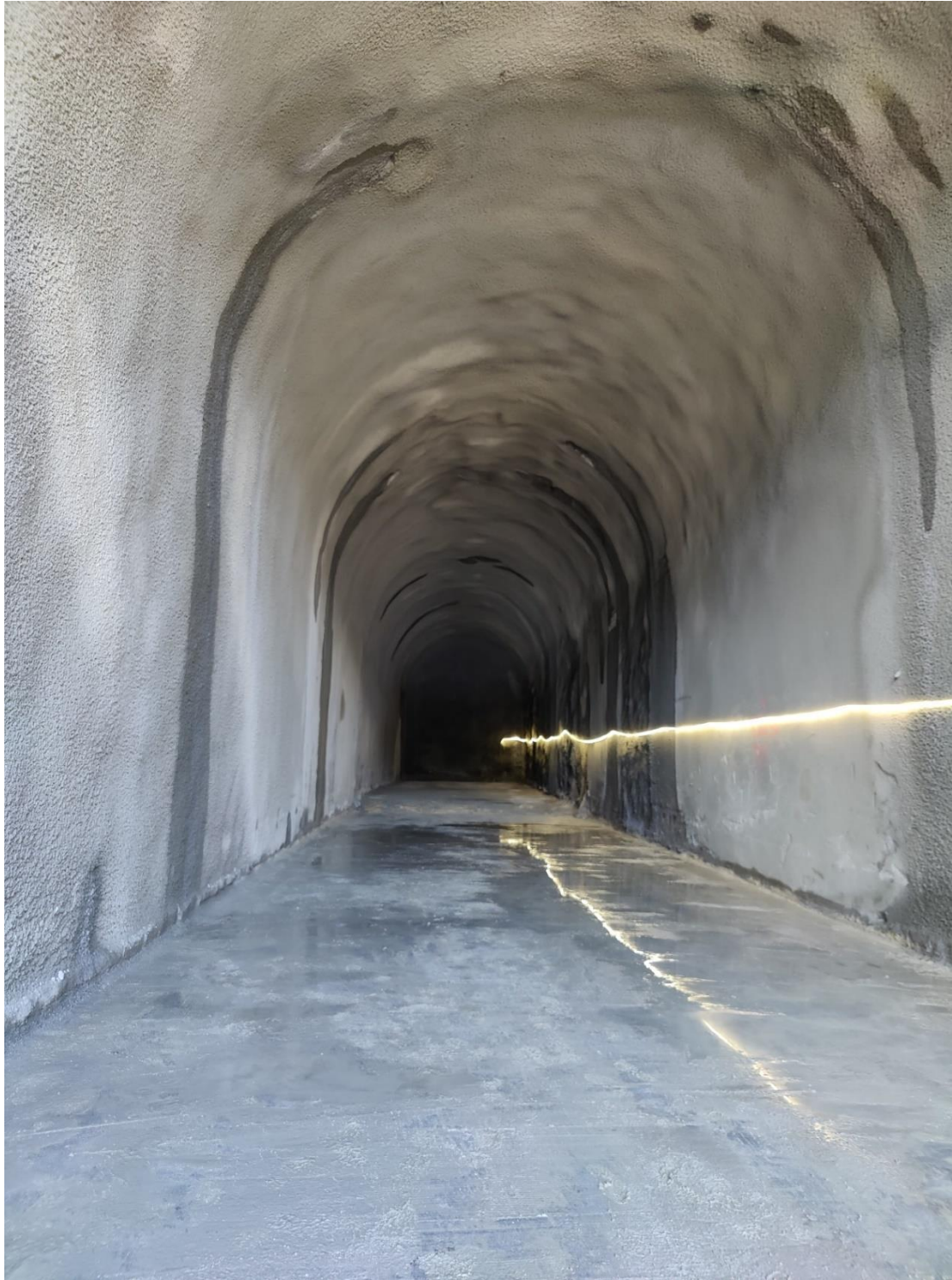
Réservoir Sur les Crêts 1893, après les travaux d'alésage et de mise en place du béton projeté (avril 2024)
